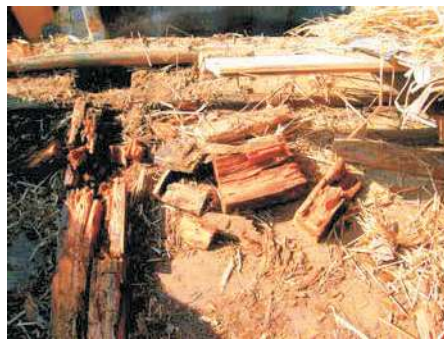
Das Ausmaß der Schäden wurde erst nach Freilegen der Dachsparren sichtbar
